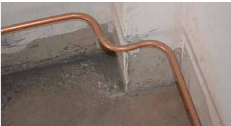
Equipotential grounding conductor
