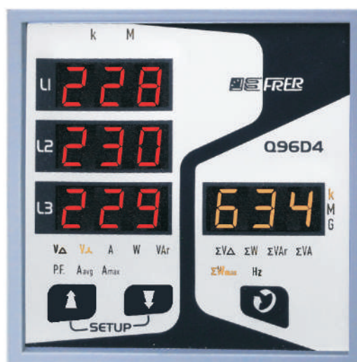
Tensioni di fase e punta massima potenza - Star voltage and Max demand power
